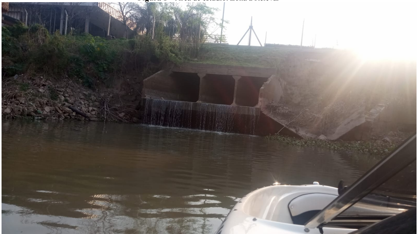
Figura 2 – Sector erosionado y talud con falla.
