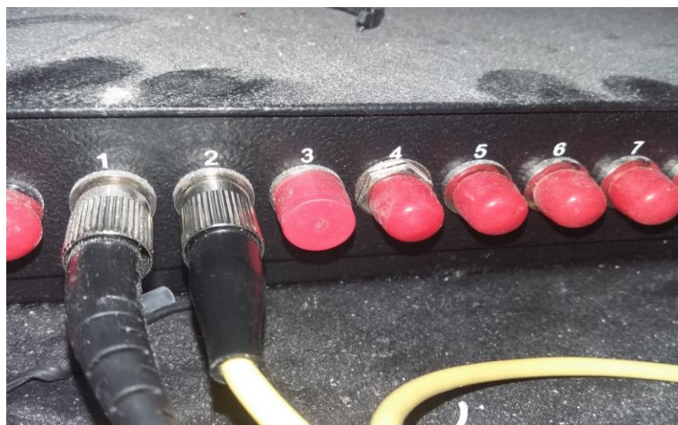
Patchera en el centro de monitoreo
